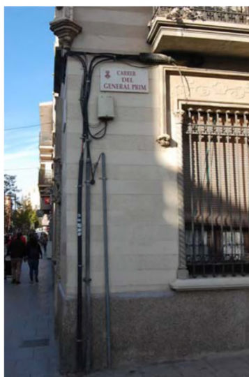
89. Instal·lacions a la façana
