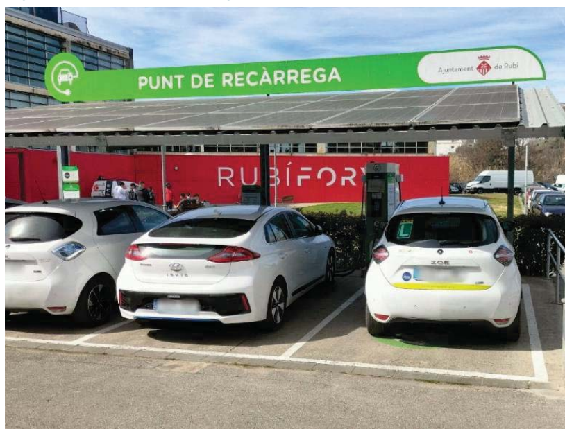
Figura 8.14. Punt de recàrrega de vehicles elèctrics
