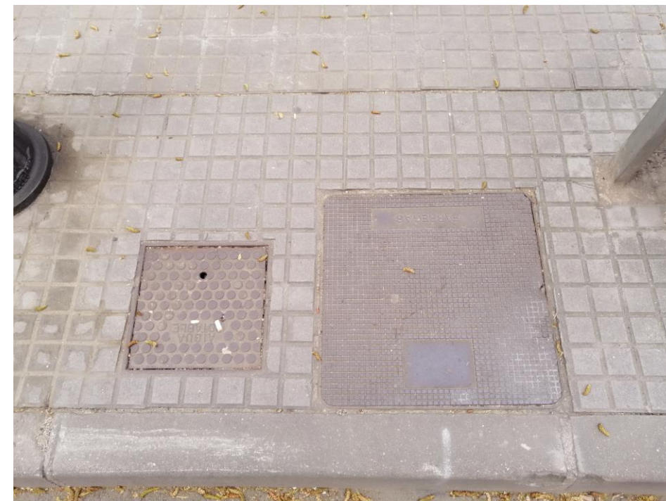
Arqueta enllumenat i arqueta d'aigua, Carrer Terrassa
