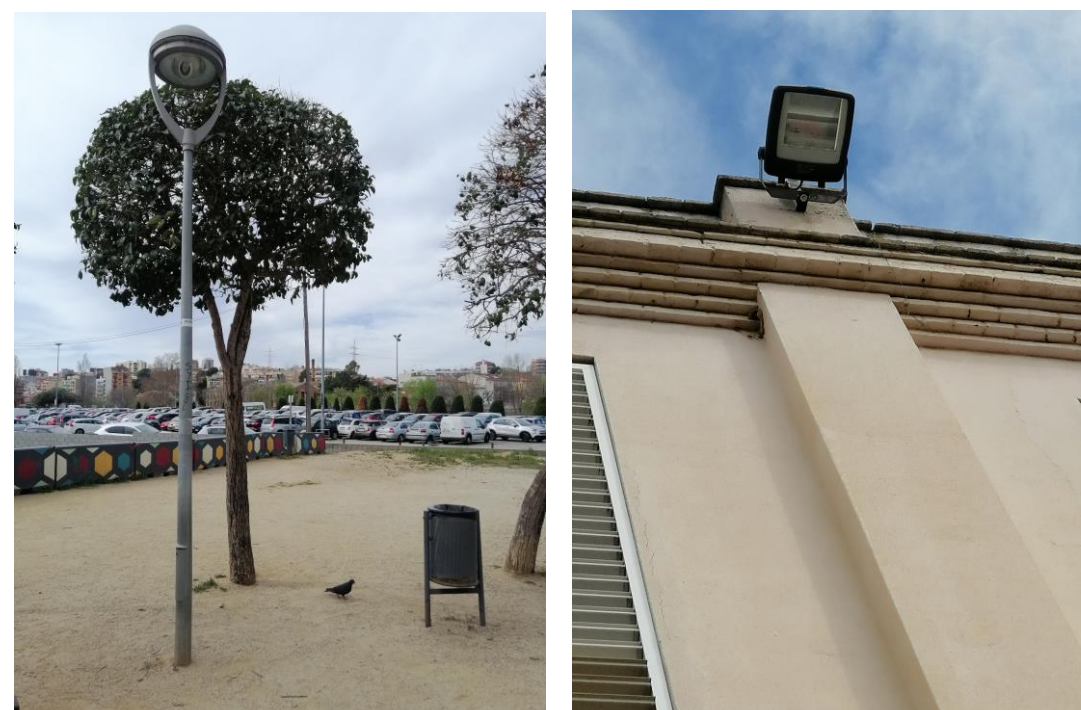
Il·luminació exterior: fanals a la plaça i a la façana de l'escola d'Art i Disseny de Rubí
