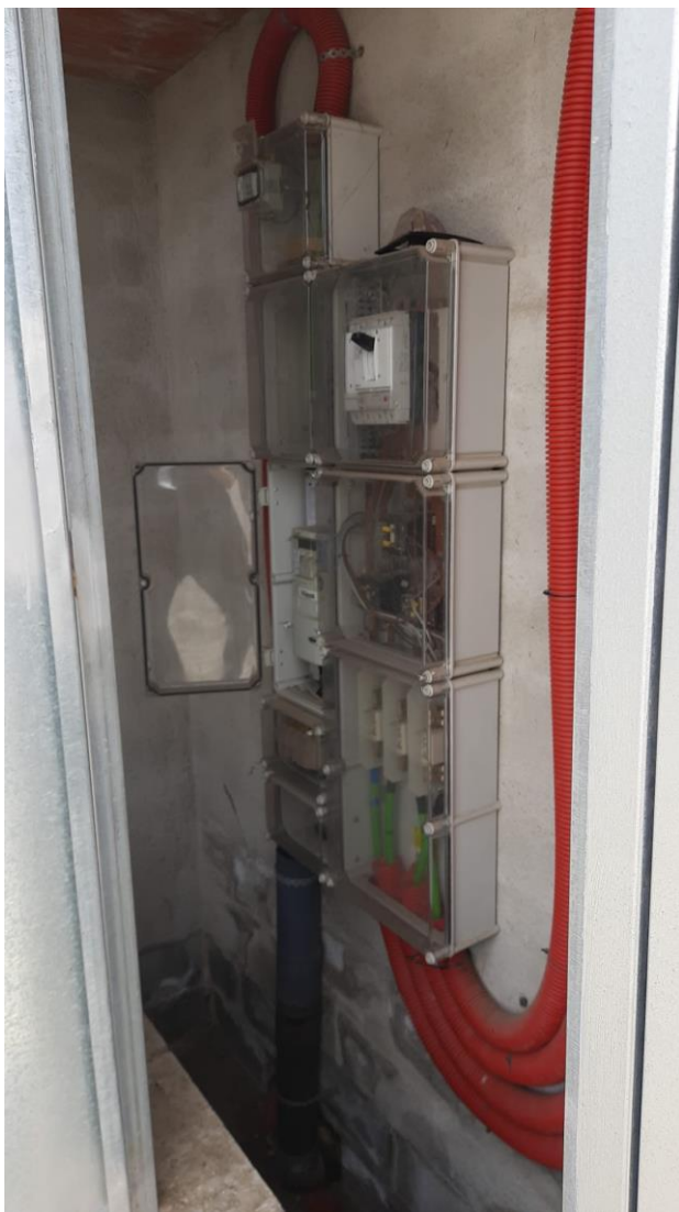
Il·lustració 7: sala del comptador de companyia distribuïdora.
