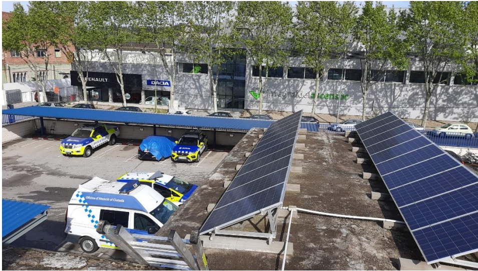
Il·lustració 3: instal·lació solar fotovoltaica existent.
