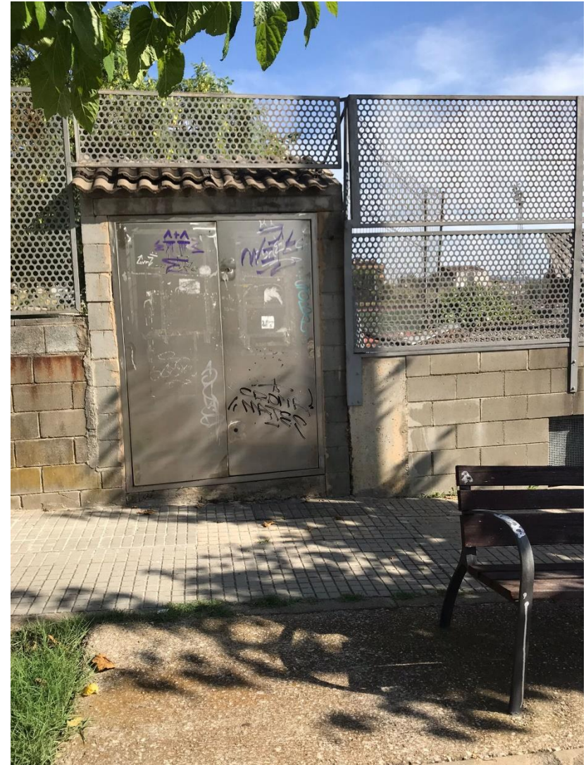
Il·lustració 6: armari del quadre general de la instal·lació. On no es disposa d'espai suficient per la nova TMF-10
