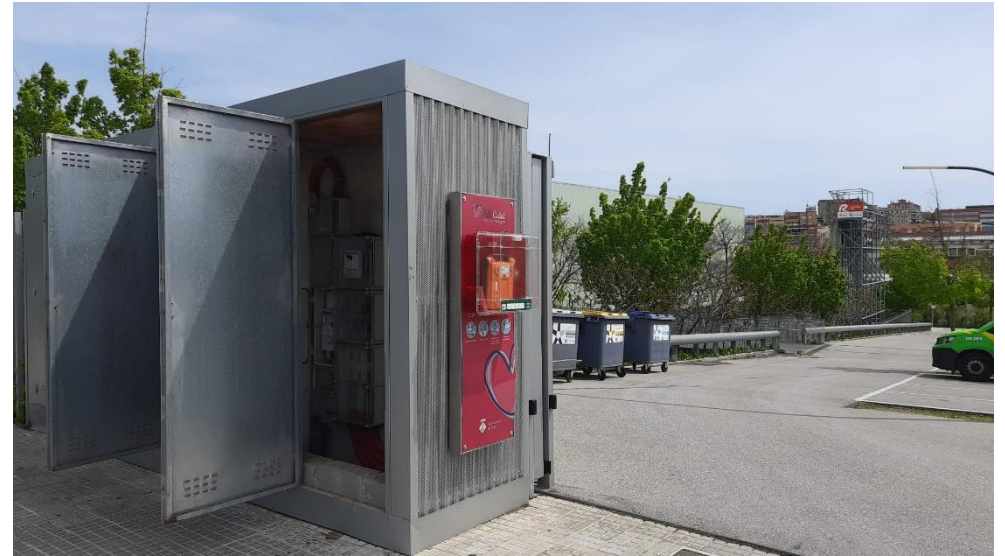
Il·lustració 6: construcció amb els quadres elèctrics del pavelló. A l'interior de la caseta, zona d'ubicació del nou comptador de companyia elèctrica.
