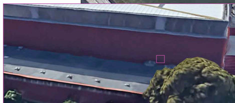
Ubicació prevista per a la instal·lació de l'inversor exterior dins d'un armari
