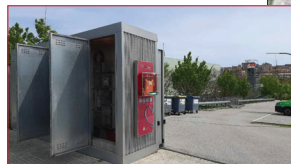
Armari on es preveu la instal·lació de la nova TMF-10
