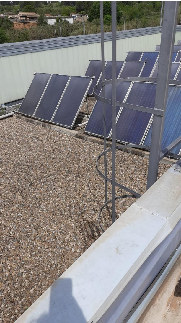
Il·lustració 3: escala de gat existent per accedir a la coberta on s'instal·laran els mòduls fotovoltaics. A la part interior, instal·lació tèrmica en desús.
