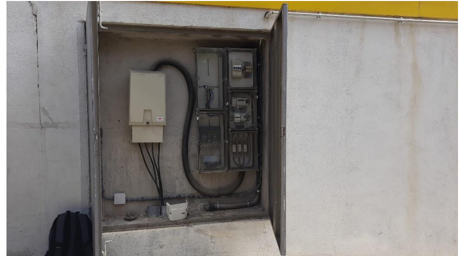
Il·lustració 2: Ubicació del quadre del comptador de l'edifici de companyia distribuïdora.
