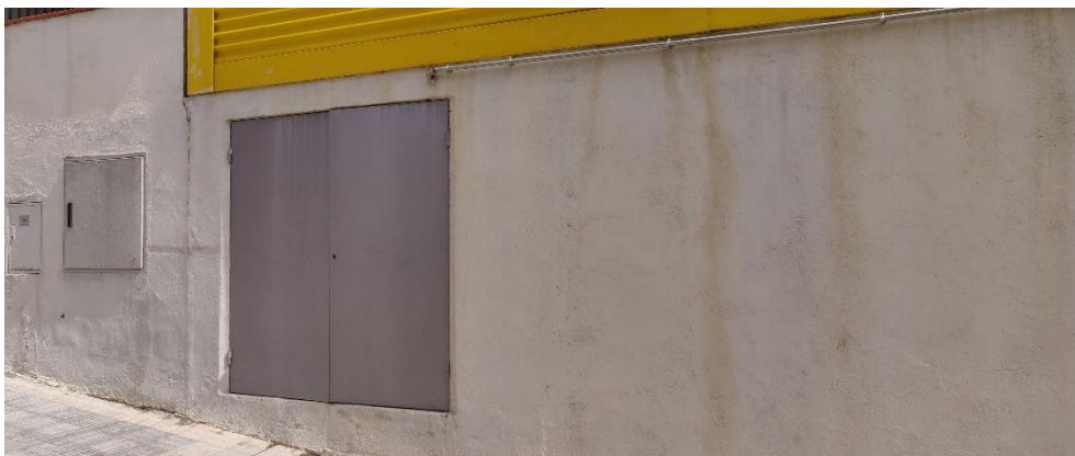
Il·lustració 5: zona prevista instal·lació nova TMF1. Dins armari de nova construcció.
