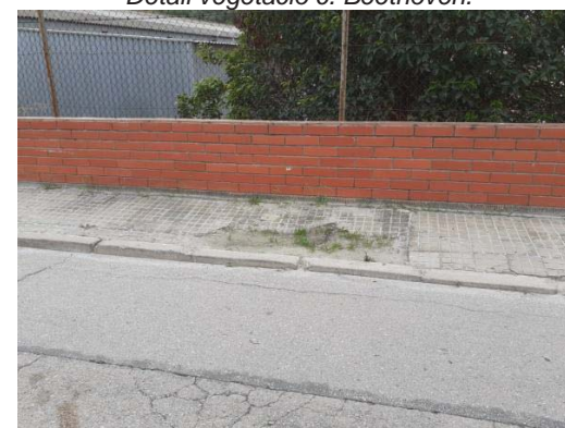
Detall c. Beethoven amb esfondrament en vorera.
