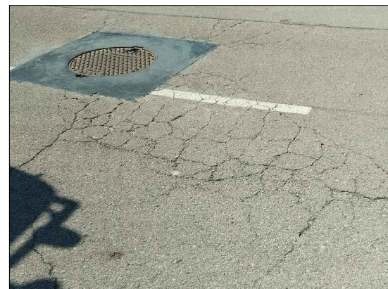
29. C. Beethoven. Fissures i pell de cocodril en capa de rodadura.
