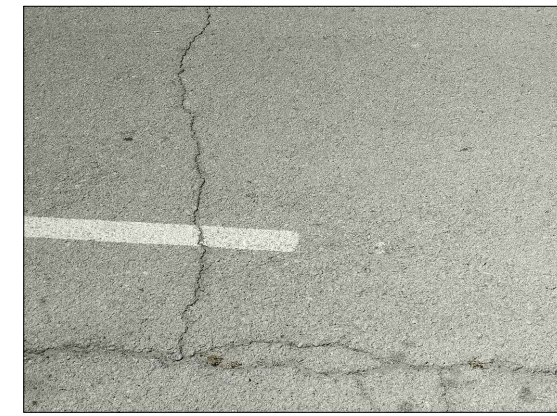
26. C. Beethoven. Fissures en capa de rodadura.
