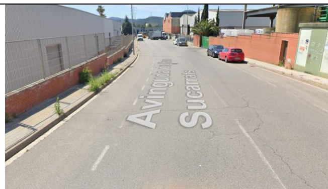
Vorera en mal estat. Vegetació en vorera. Fissures
