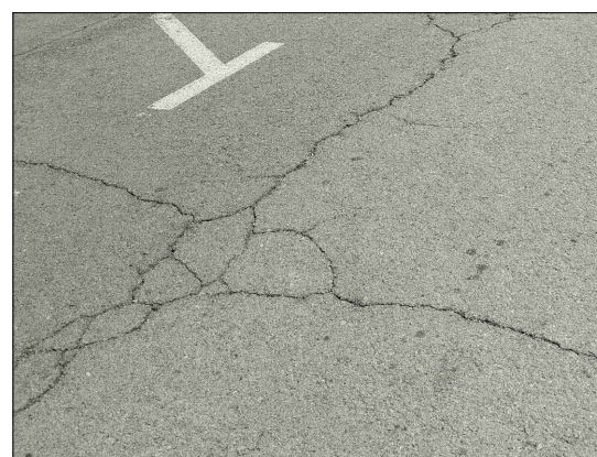
14. Tram 2 C. Chopin. Calçada amb fissures.
