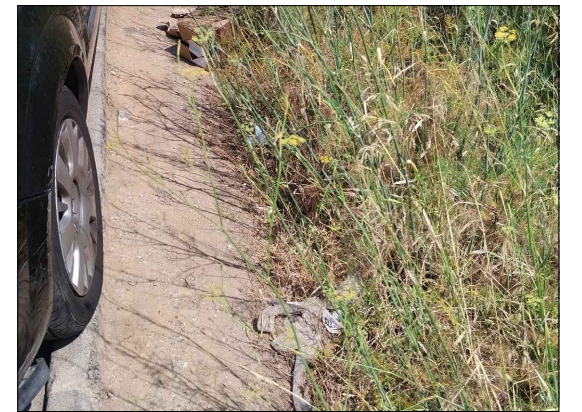
24. C. Verdi. Vorada deteriorada. Desnivell després de la calçada. Sense Vorera. Presència de vegetació.
