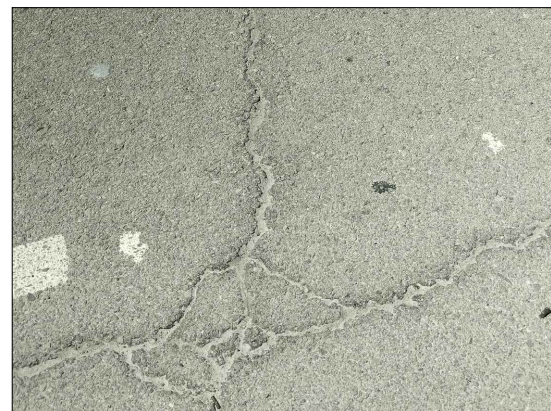
31. C. Beethoven. Detall de fissures en capa de rodadura.
