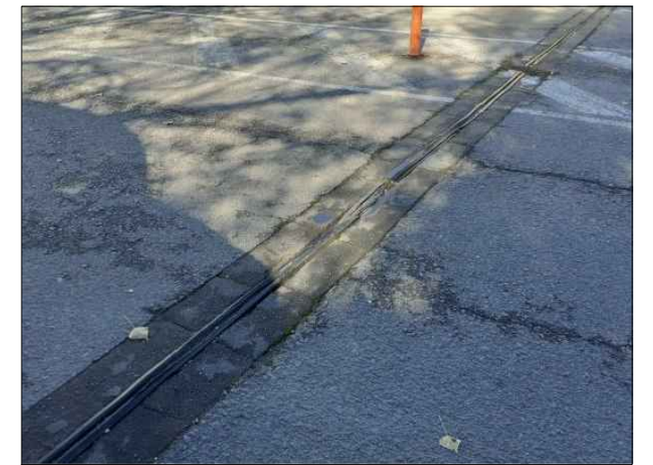
4. Pont al Carrer Leonardo Da Vinci. Detall Junta de dilatació sobre torrent dels Aious.
