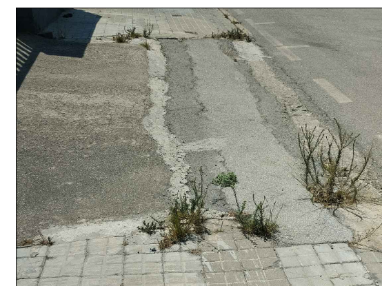
16. Güal Carrer Wagner, 6, en mal estat. Presència de vegetació.
