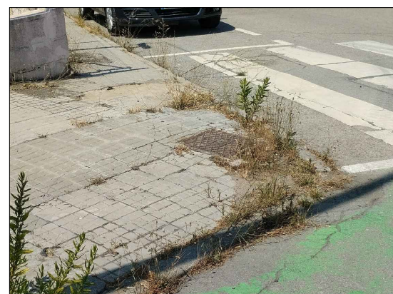
9. Tram 2 C. Chopin. Vorera en mal estat, enfonsada i malmesa.
