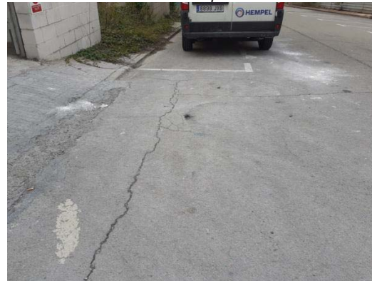
Tram 2 c. Chopin, sentit oest. Detall fissura longitudinal en sortida gual.
