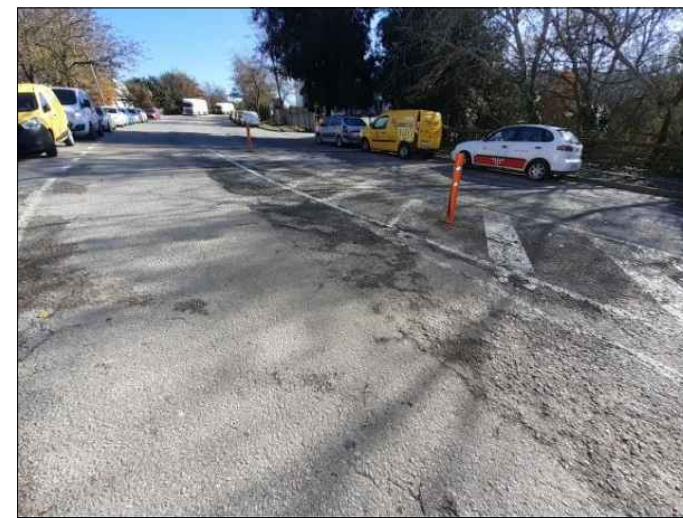
3. Pont al Carrer Leonardo Da Vinci. Capa de rodadura amb fissures, trencaments, despreniments i deformacions.
