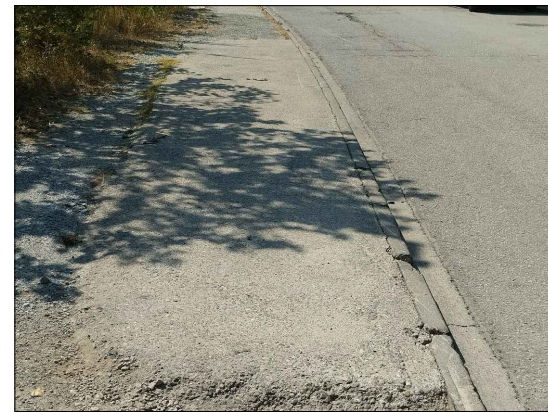
22. C. Verdi. Vorera de formigó en mal estat davant de Industries "De Pedro".
