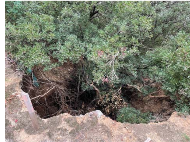
Estat de la coronació del mur amb evident estat de trencament i perillositat
