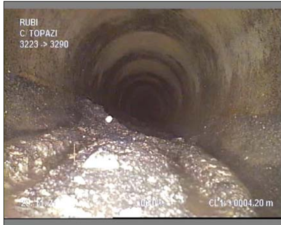
Foto: 5_5_40_A.JPG 4,2m, INTERRUPCION POR SUCIEDAD
