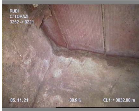
Foto: 3_3_35_B.JPG 32m, INTERRUPCION POR ARQUETA , CIEGA
