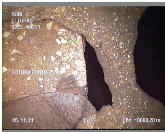
Foto: 3_3_26_A.JPG 0,2m, ROTURA PUNTUAL
