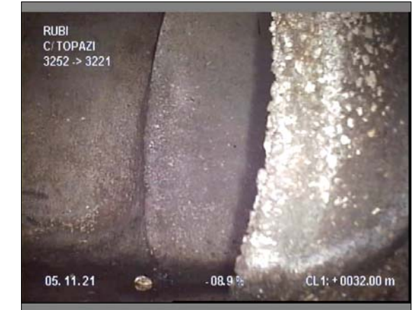
Foto: 3_3_33_B.JPG 31,9m, CONEXIÓN LADO DERECHO
