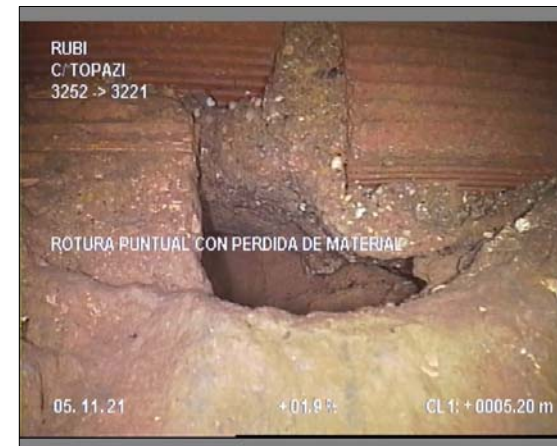
Foto: 3_3_29_A.JPG 5,2m, ROTURA PUNTUAL CON PERDIDA DE MATERIAL
