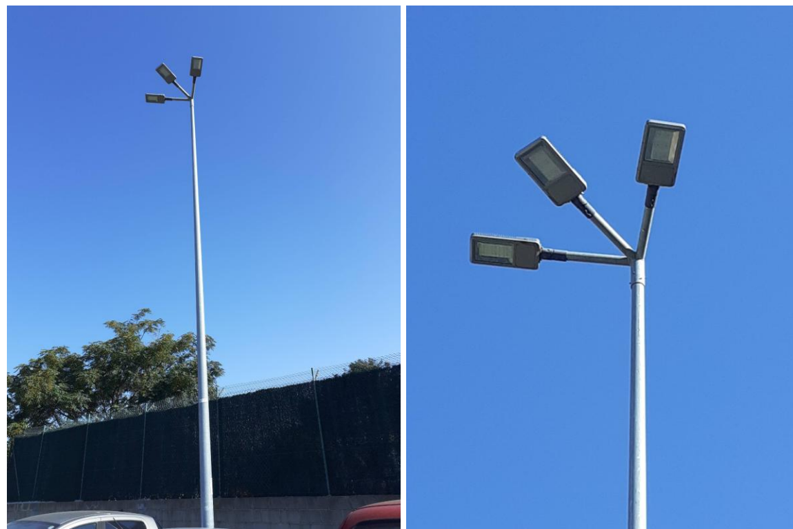
Punts de llum existent a l'aparcament de Can Fatjó.
