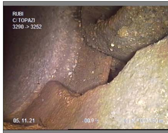
Foto: 2_2_20_B.JPG 31,8m, ROTURA PUNTUAL CON PERDIDA DE MATERIAL
