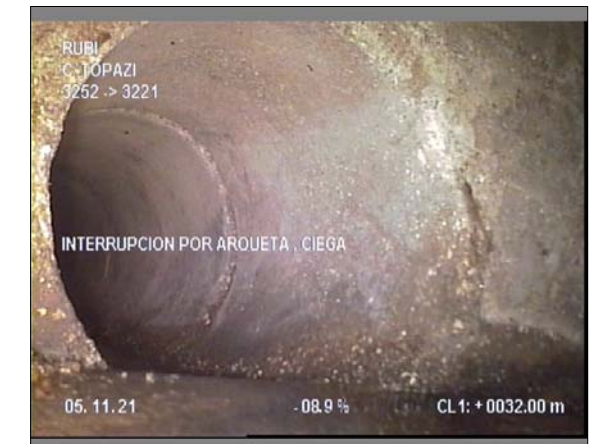
Foto: 3_3_35_A.JPG 32m, INTERRUPCION POR ARQUETA , CIEGA
