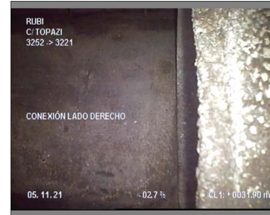
Foto: 3_3_33_A.JPG 31,9m, CONEXIÓN LADO DERECHO
