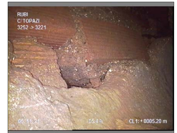
Foto: 3_3_29_B.JPG 5,2m, ROTURA PUNTUAL CON PERDIDA DE MATERIAL
