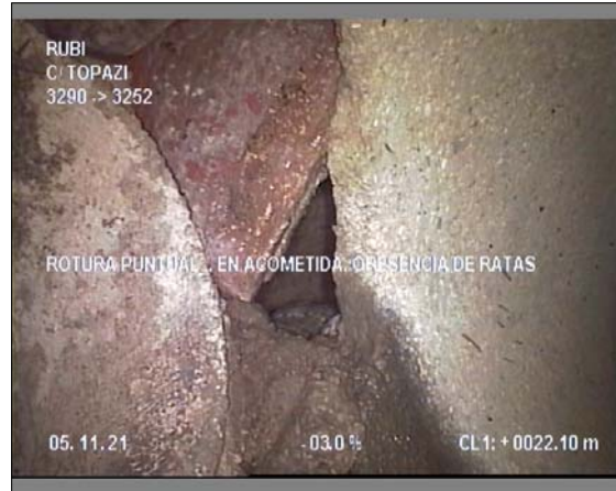
Foto: 2_2_13_A.JPG 22,1m, ROTURA PUNTUAL , EN ACOMETIDA, ORESENCIA DE RATAS
