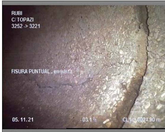
Foto: 3_3_30_A.JPG 24,9m, FISURA PUNTUAL , en junta
