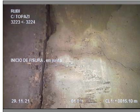
Foto: 4_4_37_A.JPG 15,1m, INICIO DE FISURA , en junta
