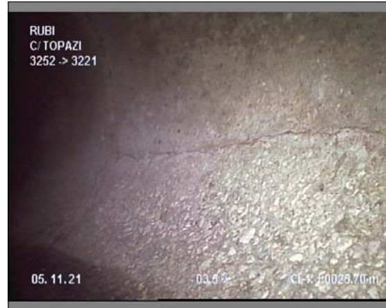
Foto: 3_3_30_B.JPG 24,9m, FISURA PUNTUAL , en junta
