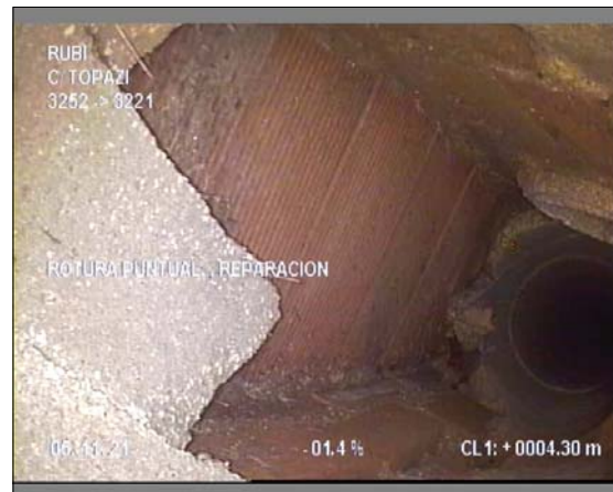
Foto: 3_3_27_A.JPG 4,3m, ROTURA PUNTUAL , REPARACION
