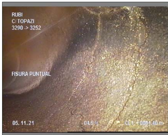
Foto: 2_2_8_A.JPG 1,4m, FISURA PUNTUAL
