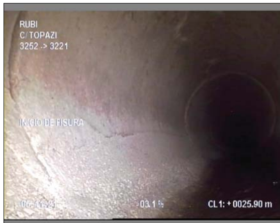
Foto: 3_3_31_A.JPG 25,9m, INICIO DE FISURA
