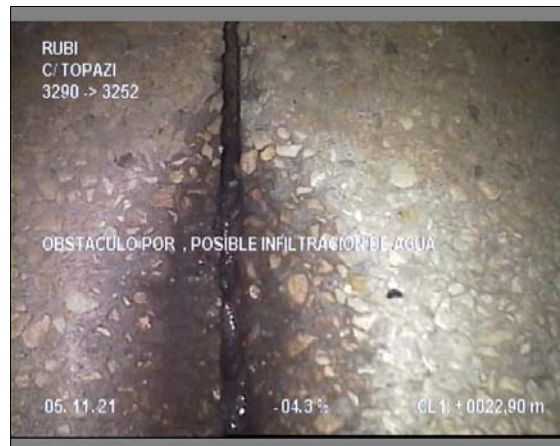
Foto: 2_2_15_A.JPG 22,9m, OBSTACULO POR , POSIBLE INFILTRACION DE AGUA
