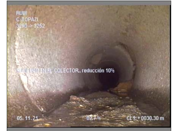
Foto: 2_2_18_A.JPG 30,3m, SUCIEDAD EN EL COLECTOR. , reducción 10%
