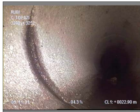
Foto: 2_2_15_B.JPG 22,9m, OBSTACULO POR , POSIBLE INFILTRACION DE AGUA
