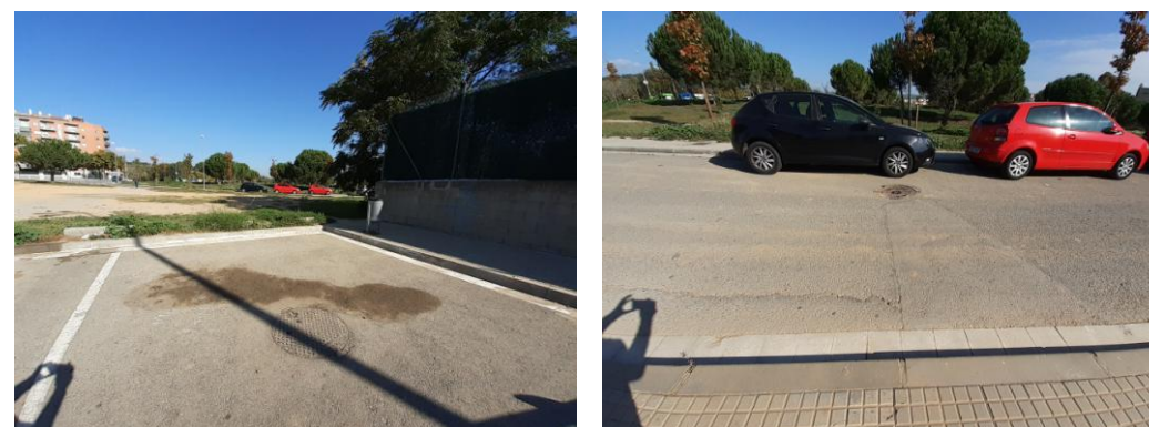
Detall tapa pou de registre col·lector pluvials que travessa l'aparcament i tapa del Passatge del Topazi.
