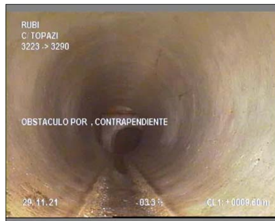
Foto: 6_6_42_A.JPG 9,6m, OBSTACULO POR , CONTRAPENDIENTE
