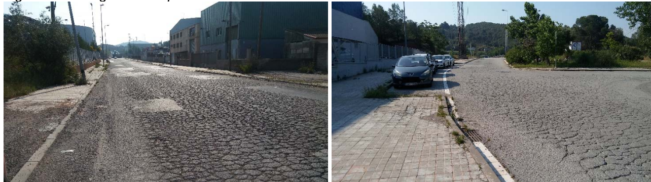
Figura 2. Patologies en els paviments de l'àmbit d'actuació
