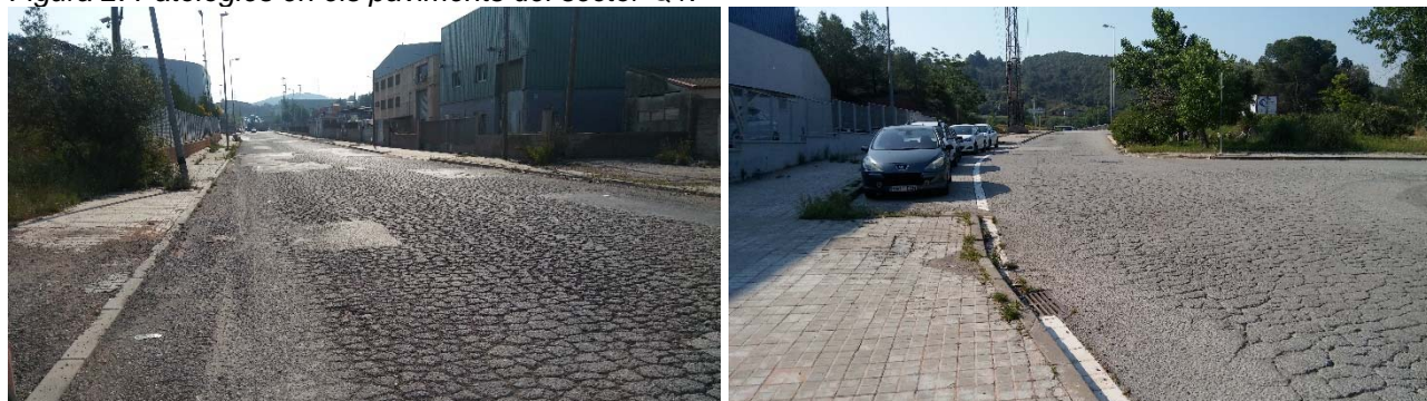
Figura 2. Patologies en els paviments del sector Q1.
