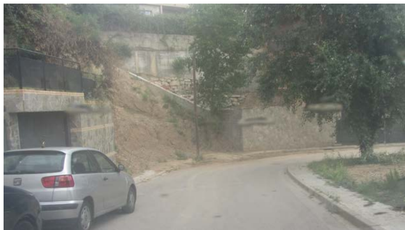
FOTO 54. Actuació AP_43. Reparació vorera dreta per assentament
