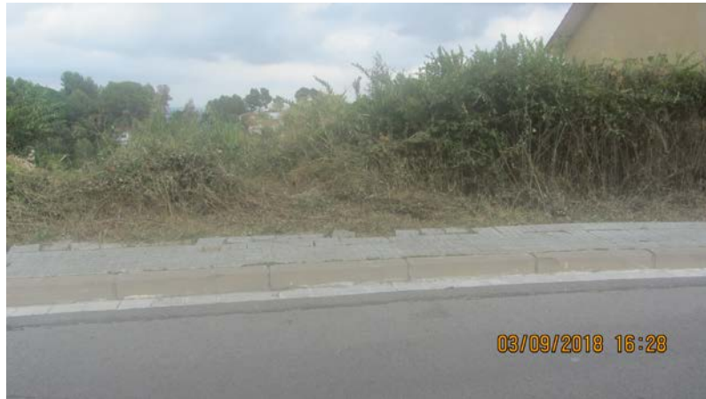
FOTO 43. Actuació AP_34. Reparació vorera en mal estat
