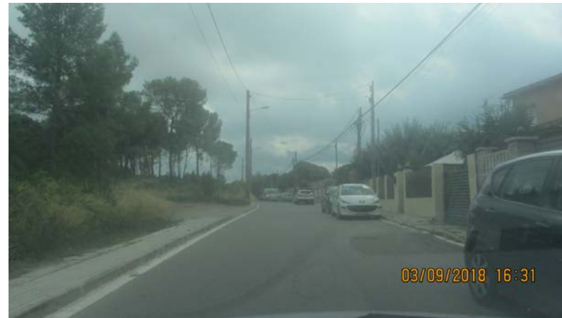
FOTO 47. Actuació AP_38. Reparació vorera dreta mal estat
