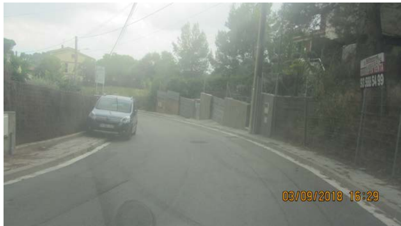
FOTO 44. Actuació AP_35. Reparació vorera en mal estat
