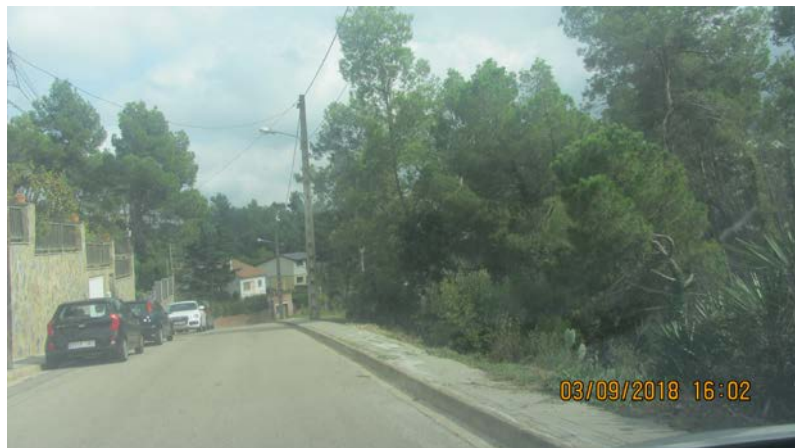
FOTO 3. Actuació AP_02. Reparació vorera (dreta imatge), per assentament de la seva base.
