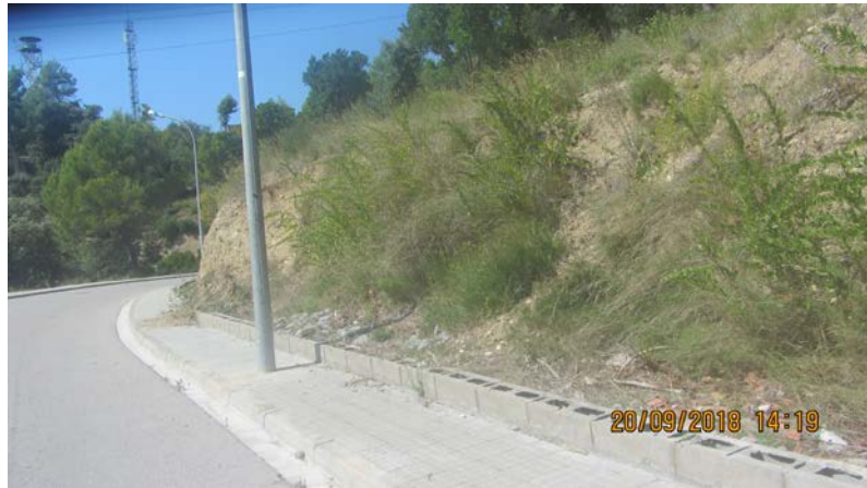
FOTO 1. Actuació AT_01. Reperfilat talús
