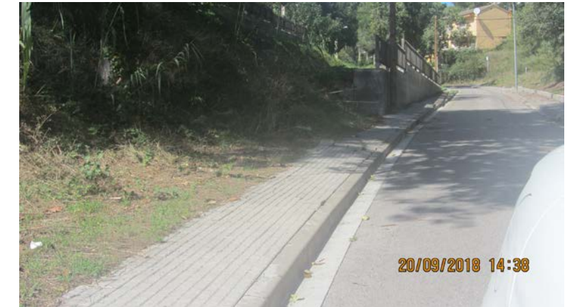
FOTO 20. Actuació AP_04.Reparació vorera en mal estat
