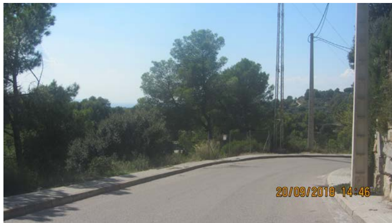
FOTO 24. Actuarió AP_08.Reparació flonjall arrels (carril esq) al fons de la imatge
