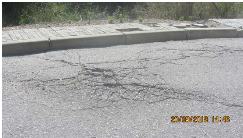
FOTO 25. Actuarió AP_08.Detall flonjall fotografia anterior i reparació vorera en mal estat
