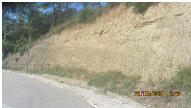
FOTO 2. Actuació AT_01. Reperfilat talús
