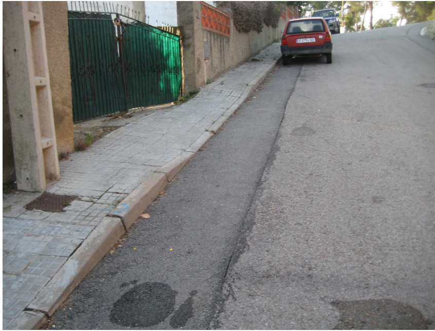
Reparació superficial fruit de pas d'instal·lacions
