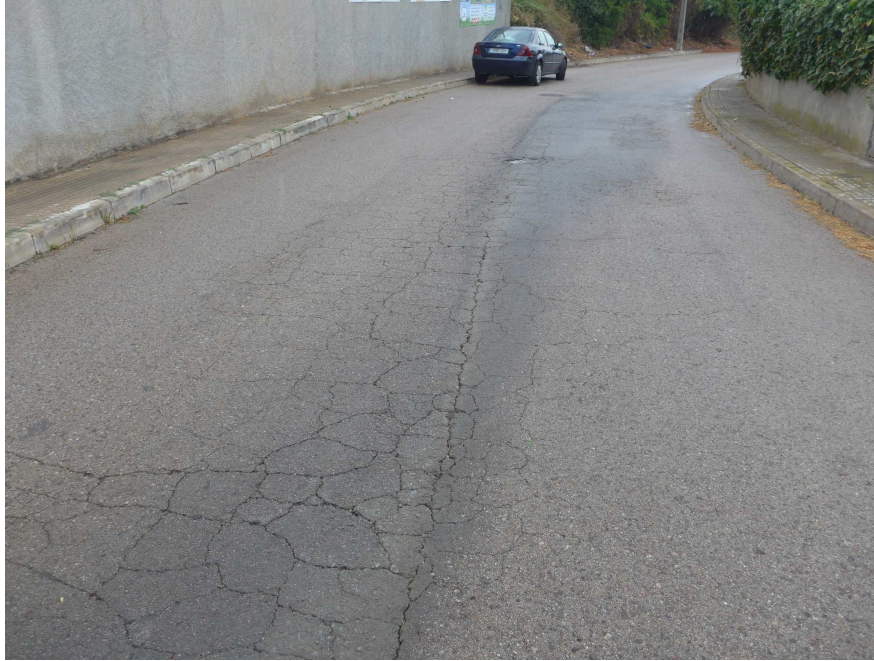
Pell de cocodril i fissures longitudinals
