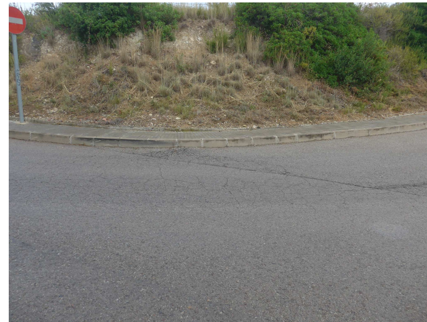
Pell de cocodril en capa de rodadura
