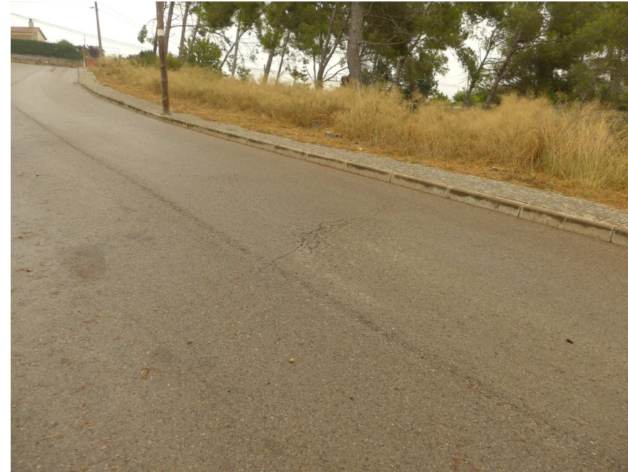
Petita fisura transversal
