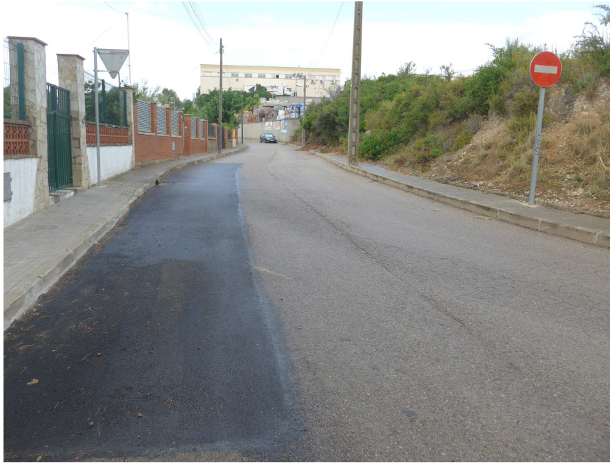
Reparació longitudinal lligada a pas d'instal·lacions
