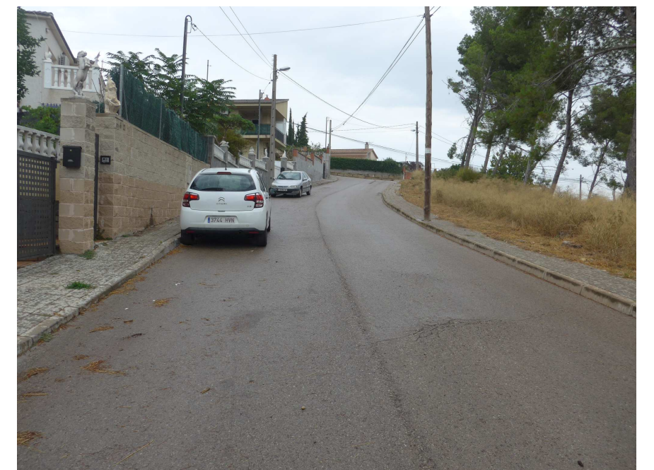
Afectació puntual a calçada, aixecament de la capa de rodadura
