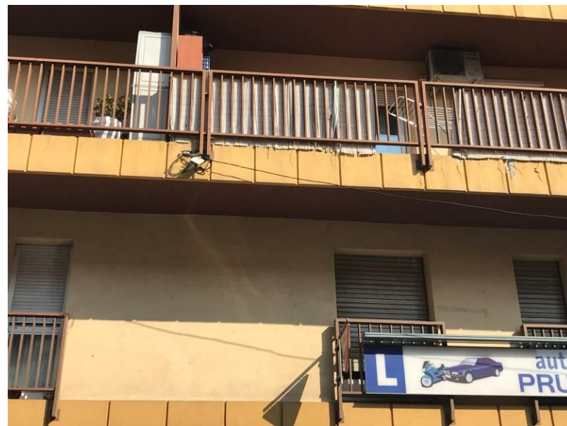
Cables elèctrics aeris
