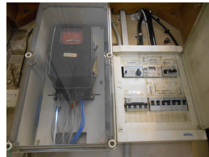
QUADRE ELÈCTRIC I COMPTADOR
