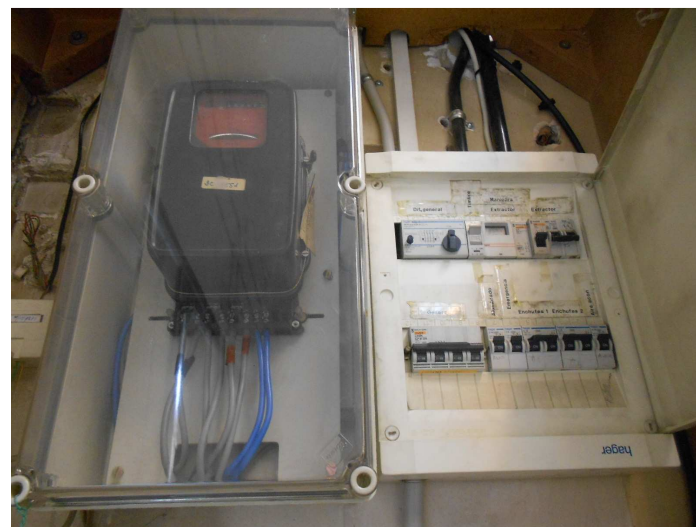
QUADRE ELÈCTRIC I COMPTADOR
